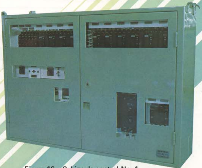
Figura 16. Cabina de control No. 1
